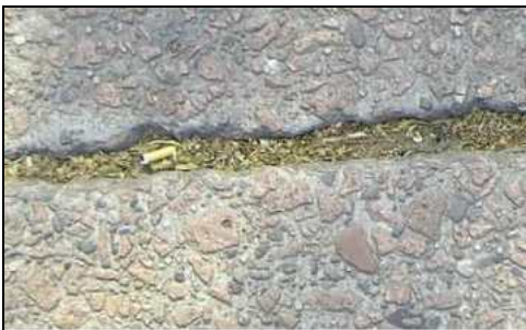
Figura 4: Degrado dei giunti non sigillati
