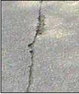
Figura 2: Esempio di fessurazione longitudinale
