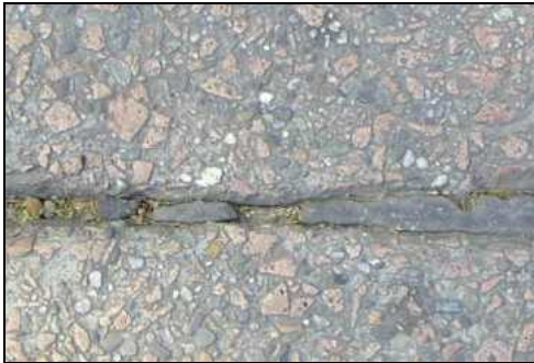
Figura 5: Degrado dei giunti precedentemente sigillati
