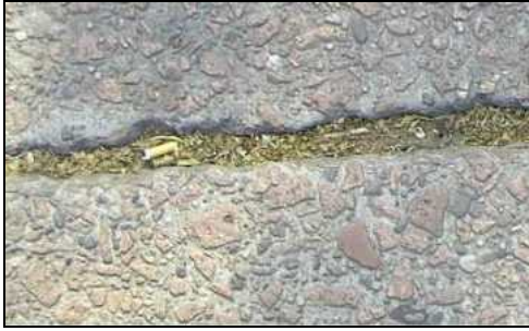
Figura 4: Degrado dei giunti non sigillati
