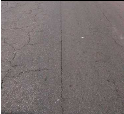
Figura 11: Fessura longitudinale da giunto di stesa.
