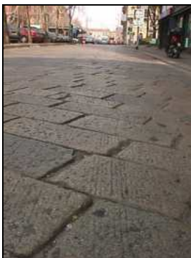
Figura 12: Eccessiva apertura dei giunti non sigillati
