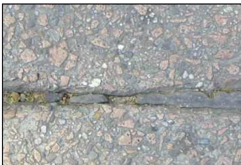
Figura 5: Degrado dei giunti precedentemente sigillati
