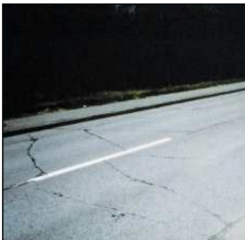
Figura 3: Esempio di fessurazione trasversale
