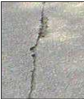
Figura 2: Esempio di fessurazione longitudinale
