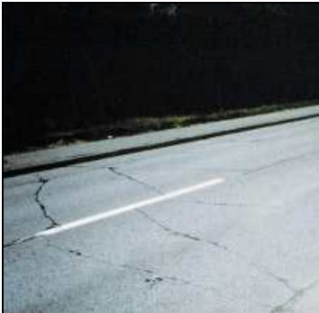
Figura 3: Esempio di fessurazione trasversale
