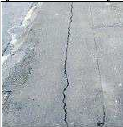
Figura 8: Esempio di fessura longitudinale
