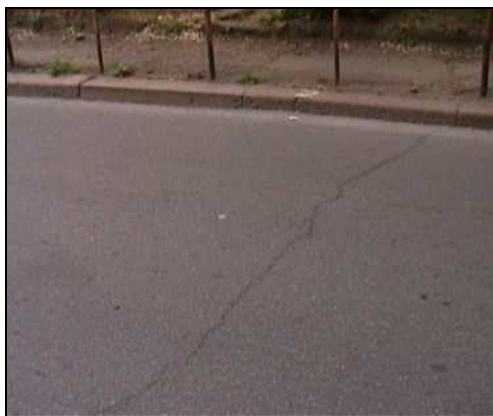
Figura 10: Esempio di fessura trasversale
