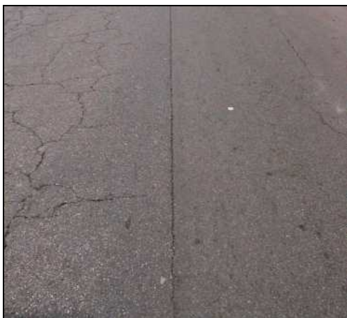
Figura 11: Fessura longitudinale da giunto di stesa.
