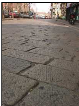
Figura 12: Eccessiva apertura dei giunti non sigillati
